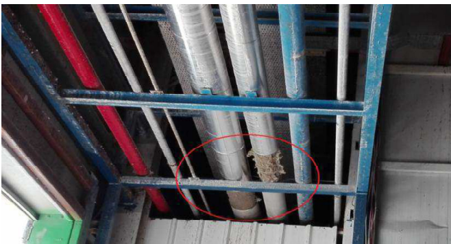
Fig. 7 Imperfection de la protection de l'isolation
