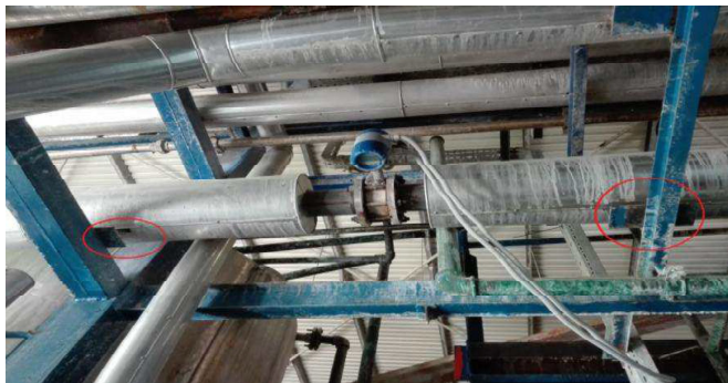
Fig. 6 Pont thermique par les supports et les appuis
